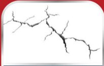
ผนังร้าว CRACKED WALL
